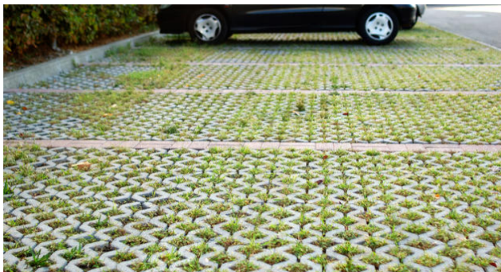
Figura 12 – Imagem do pavimento permeável em uma área de estacionamento.
