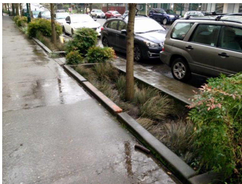
Figura 6 – Foto de uma via no centro da cidade de Portland, EUA, com sistema de biorretenção implantada pela prefeitura e a Universidade de Portland (projeto Green Street). Extraído do website Instituto Telhado Instituto Mobilidade Verde (2016).
