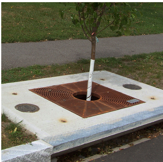
Figura 9 – Imagem de filtro de caixa de árvore instalado em Milton, Massachusetts, EUA.
